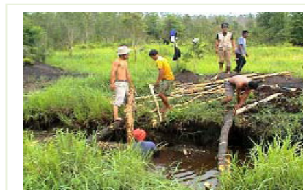
Gambar 45. Pemasangan kayu penyangga melintang bawah dan atas (Sumber: Panduan Penyekatan Parit dan Saluran di Lahan Gambut Bersama Masyarakat, WI-IP. 2005)
