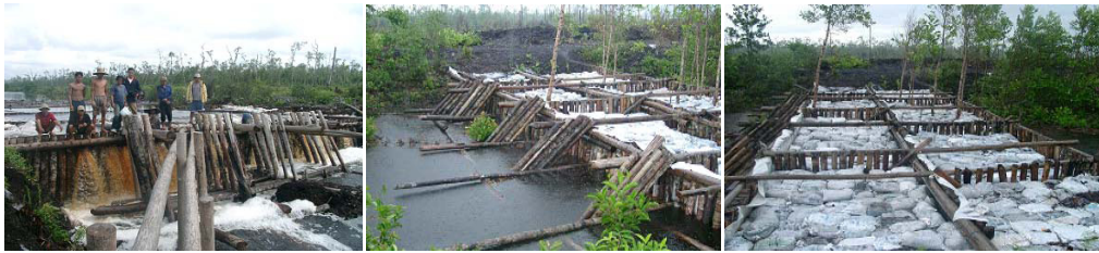
Gambar 36 : 1.Tiang belangiran pengunci/penopang (brancing) pada bagian belakang Tabat, 2 dan 3. Kamar pada tabat Model DTM-2 dengan kamar-kamar yang telah dilapisi geotextile dan diisi karung tanah mineral (Foto: I N.N. Suryadiputra 2004) (Sumber: Panduan Penyekatan Parit dan Saluran di Lahan Gambut Bersama Masyarakat, WI-IP. 2005)
