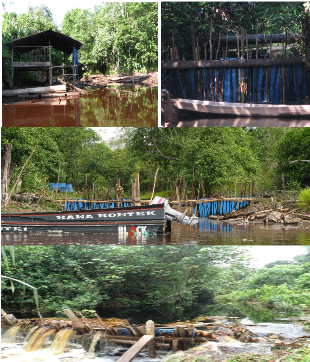
Gambar 61: 1. Salah Satu Parit/Kanal di Sungai Buring, 2&3. Penyekatan Parit/Kanal di sekitar Sungai Buring (Foto:Baba, 2009), 3. Kayu Log di dalam sekat sementara (Foto : Dok MRPP-2009)
