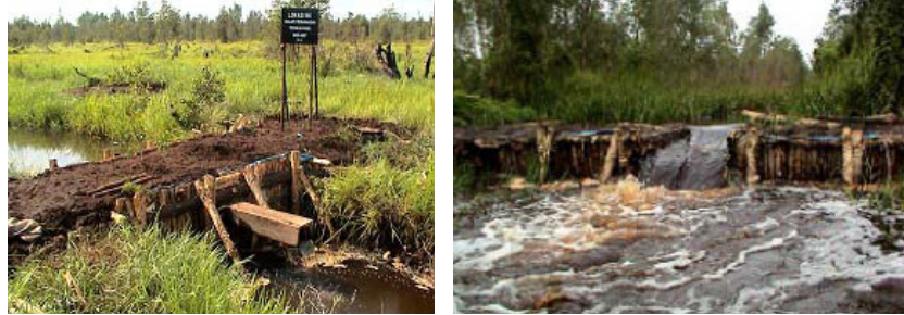
Gambar 49. Posisi dan bentuk saluran pembuangan air (spillway) di tengah tabat (Sumber: Panduan Penyekatan Parit dan Saluran di Lahan Gambut Bersama Masyarakat, WI-IP. 2005)
